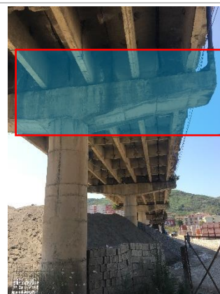
Korrodimi i shufrave punuese në jastëk
